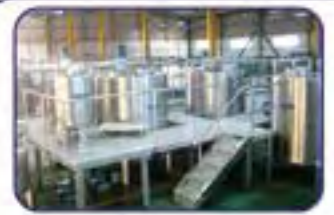
Unité de préparation pharmaceutique
